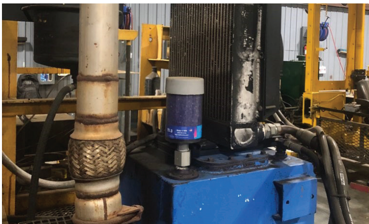
Un sistema de energía hidráulica utiliza un respiradero desecante TTI Desiccant Power Breather™ para proteger los componentes de acero del equipo contra la corrosión.
